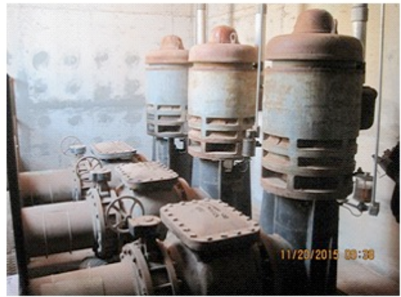
(d) Three 100-hp 6500-gpm pumps
